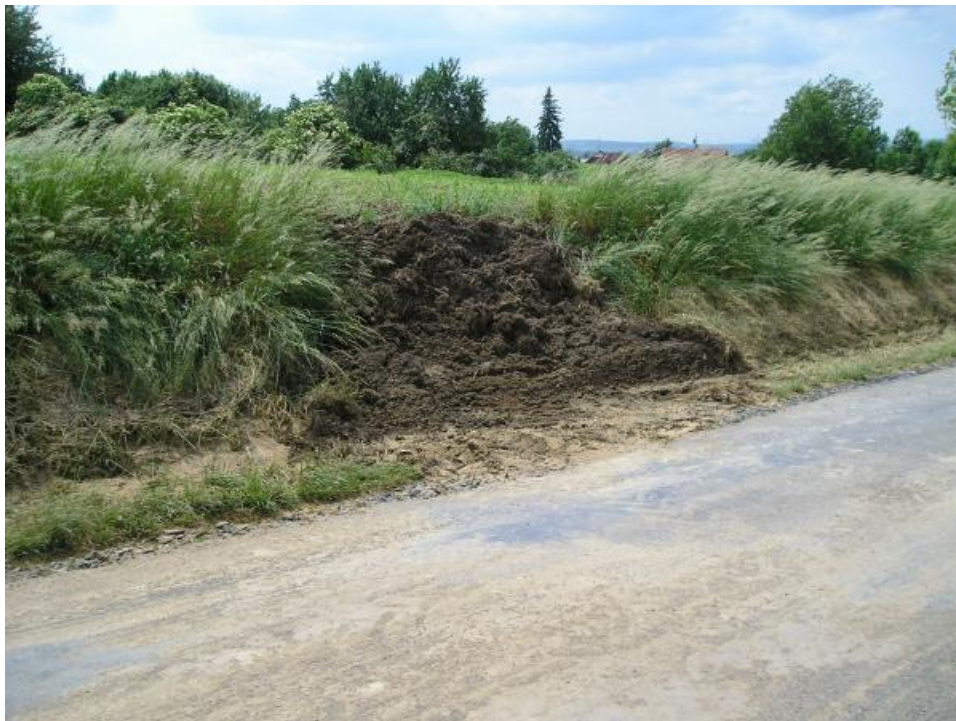
Obr. 19: Sesuv stěny příkopu na levé straně silnice do Smržic
